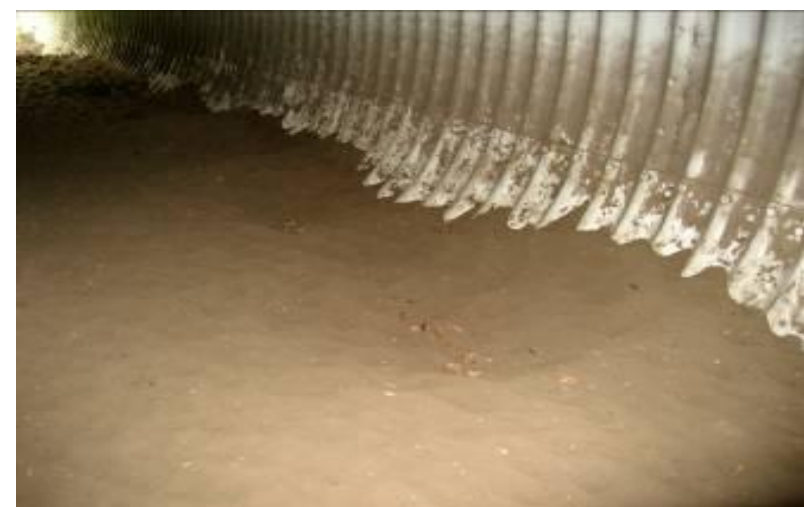
Wildtiertunnel in Veluwe, Niederlande. Fotos: RNG (5/08).
